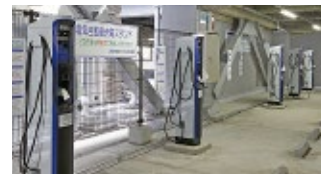
2階 EVスタンド
