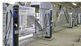
2階 EVスタンド
