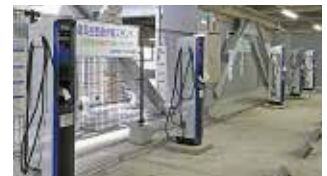
2階 EVスタンド
