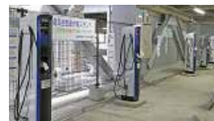
2階 EVスタンド
